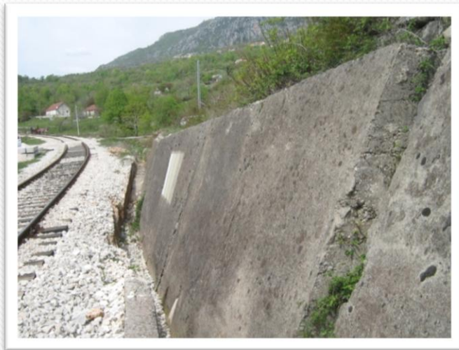
Pukotina smicanja na kampadi br. 3
