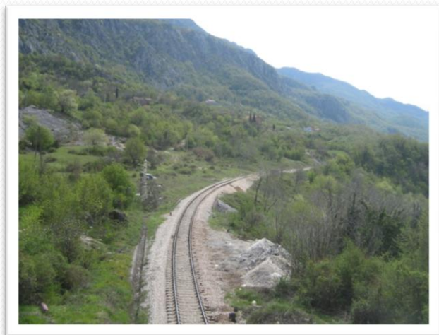
Klizište “Povija” stacionaža 13+300 – 13+530
